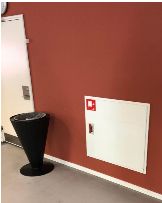
Ved personaledøren: brandslange
